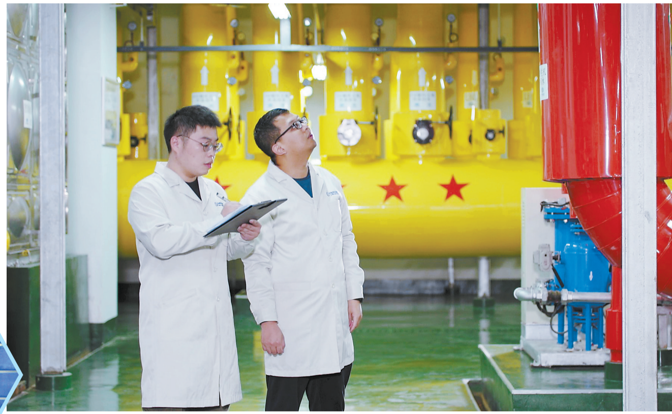
现场巡检人员进行水泵运行压力参数核对作业。(福州移动供图)
