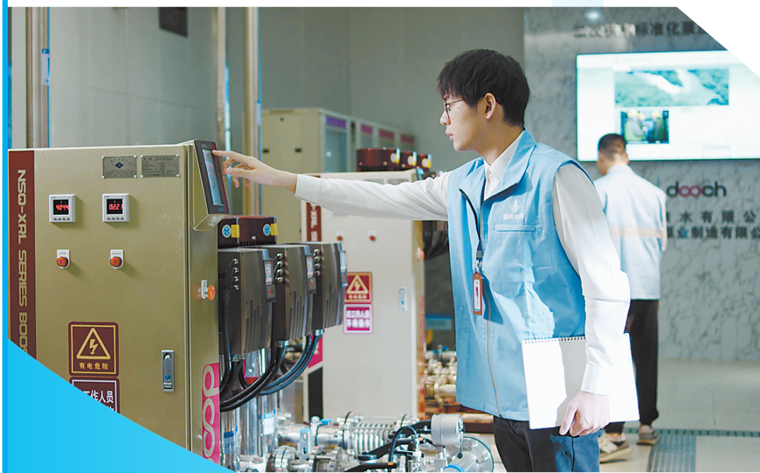
技术人员查看二次供水管理平台。
