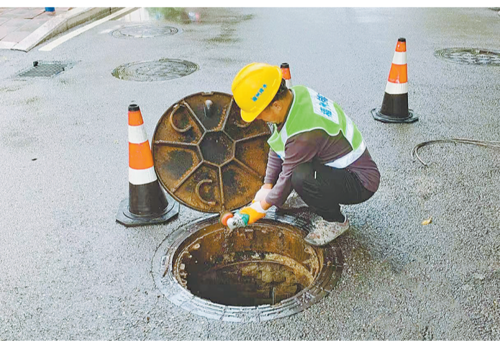
施工人员进行防沉降井盖消音法处理问题井盖。(市排水公司供图)
