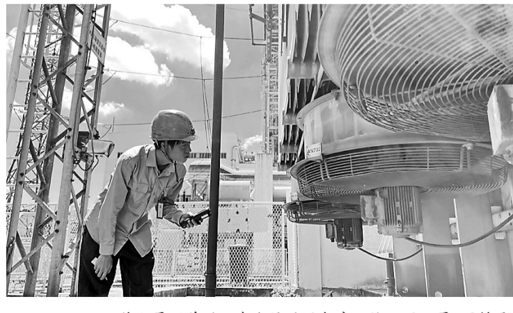
工作人员顶着烈日在发变的设备旁巡检。通讯员 原锦雯 摄
