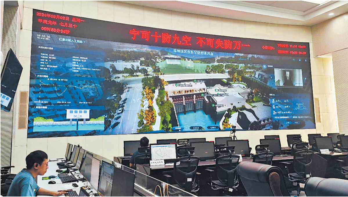
在福州市城区水系联排联调中心指挥大厅,工作人员通过大屏幕实景三维系统关注城区河道水情。 本报记者 赖志昌摄
