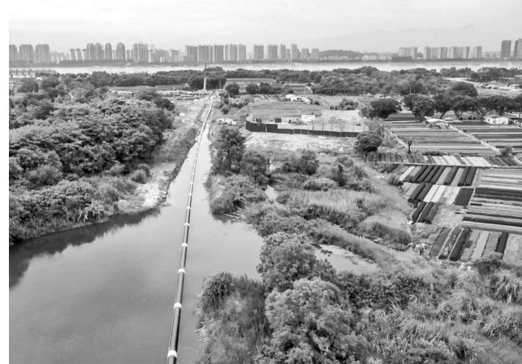
施工中的飞凤山水厂至高新区过江供水管道,该项目已竣工。(市住建局供图)
