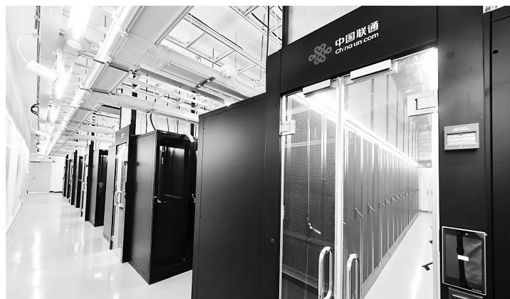
联通“智·云”数据中心机房。
